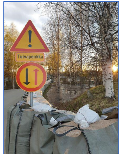
Kuva 10. Suurhiekkasäikeistä tehty tulvasuojaus Rovaniemen Saarenkylässä Halvarinrannassa vuoden 2020 kevättulvalla.
